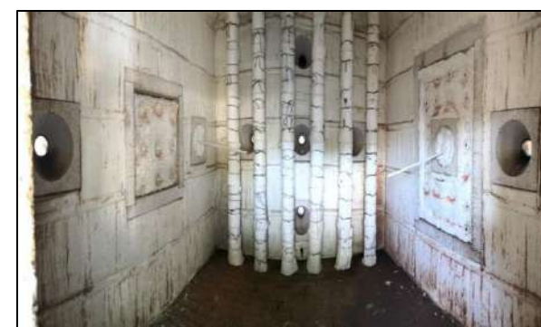
Вид внутри печи
