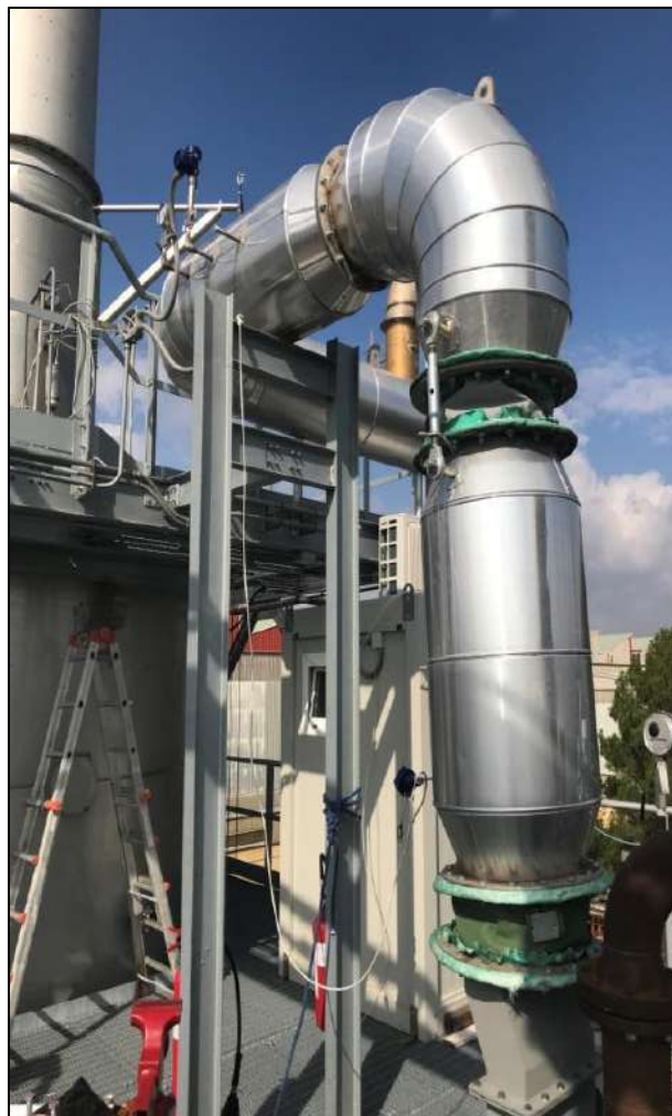
Трубопровод горячего воздуха
