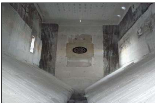
Котел 50 мВт (12 x 4.4 x 6м)
